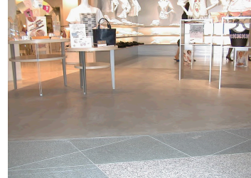
店舗床劣化防止
