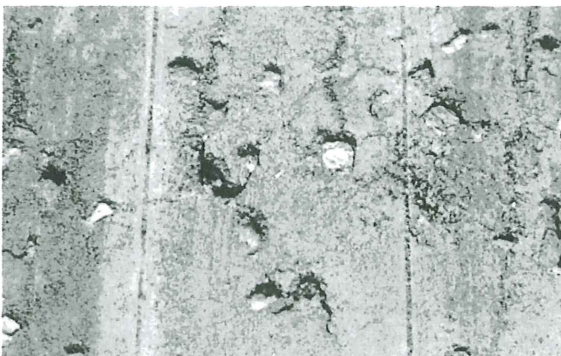
写真1 外壁打放し面の中程度のポップアウト
