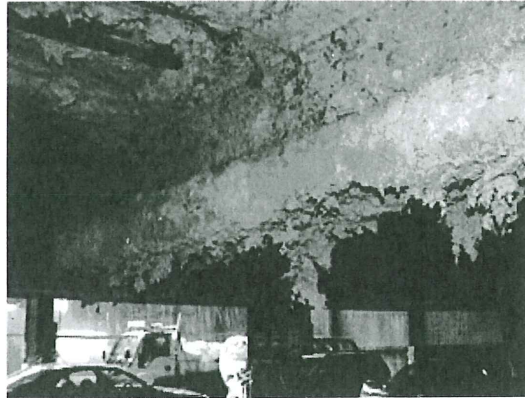
写真3 吹付けアスベスト
